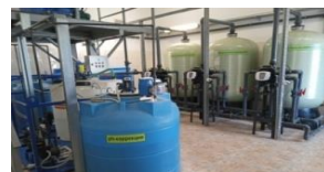
Очистные сооружения ст. Белово
