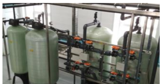
Очистные сооружения ст. Омск-Пассажирский
