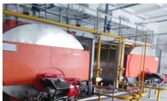
Газовая котельная ст. Омск-Пассажирский
