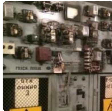
Тяговая подстанция 1950-х гг., Нижний Новгород
