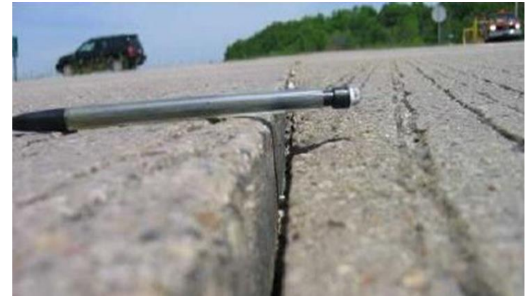
Вертикальное смещение плит
