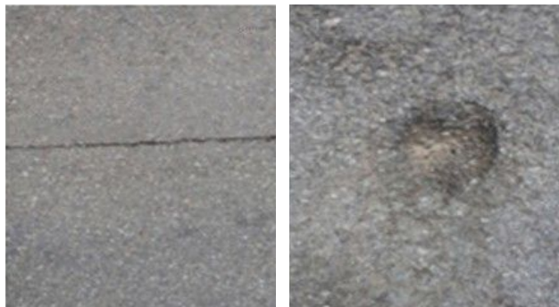
Примеры повреждений дорожного полотна
