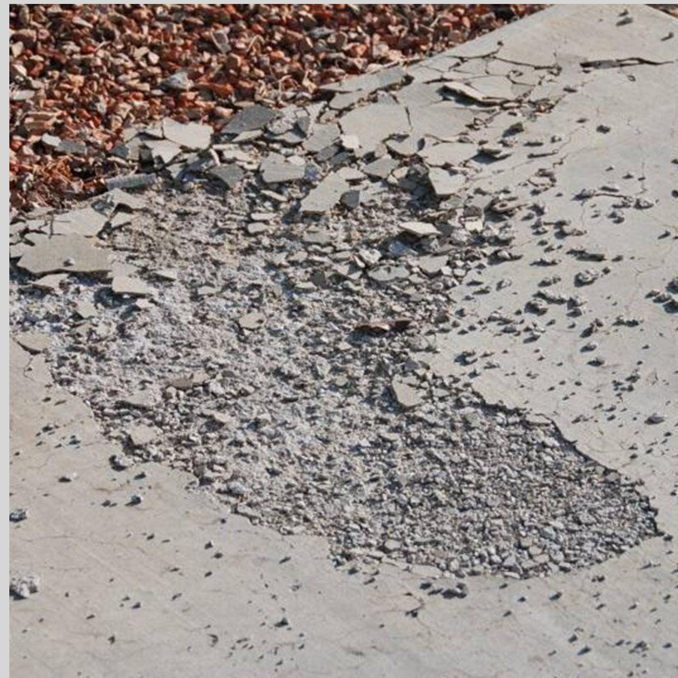
НЕКАЧЕСТВЕННАЯ ОТДЕЛКА = ДЕФЕКТЫ ПОВЕРХНОСТИ
